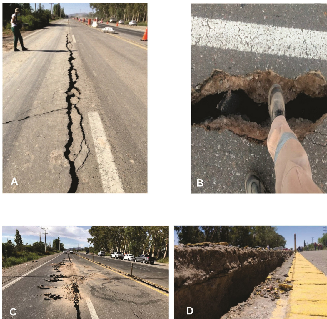
FIG. 8. Formación de grietas y asentamientos diferenciales en un tramo de la ruta nacional N° 40, en la localidad de Carpintería. A. Foto de los autores. B. Foto extraída del Diario Tiempo de San Juan, https://www.tiempodesanjuan.com/sanjuan/2021/1/19/fotos-videos-lo-que-dejo-el-terremoto-en-san-juan-304417.html . C. Foto de los autores. D. Foto extraída del Diario La Provincia, https://www.diariolaprovinciasj.com/sociedad/2021/1/19/terremoto-en-san-juan-las-consecuencias-departamento-por-departamento-146363.html
